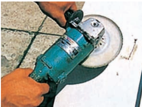
La discatura è uno dei sistemi più efficaci per preparare una superficie all'applicazione di RESINA 2000.
